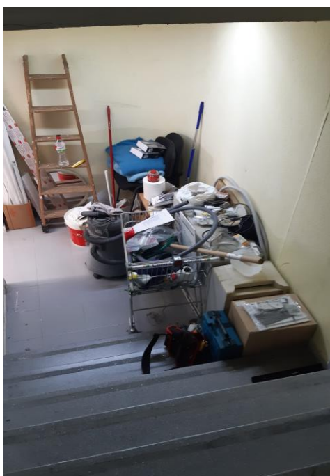
Acumulació de materials. Zona sense detecció de fums
