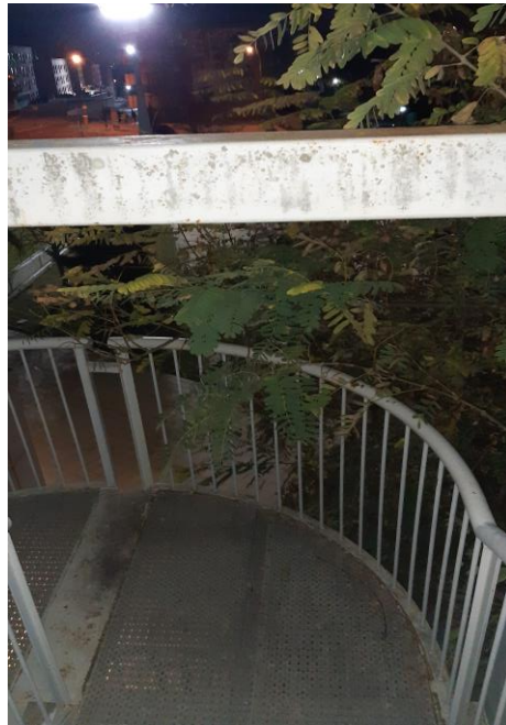
Possibilitat de cops amb estructura, presència de branques a la zona d'evacuació.
