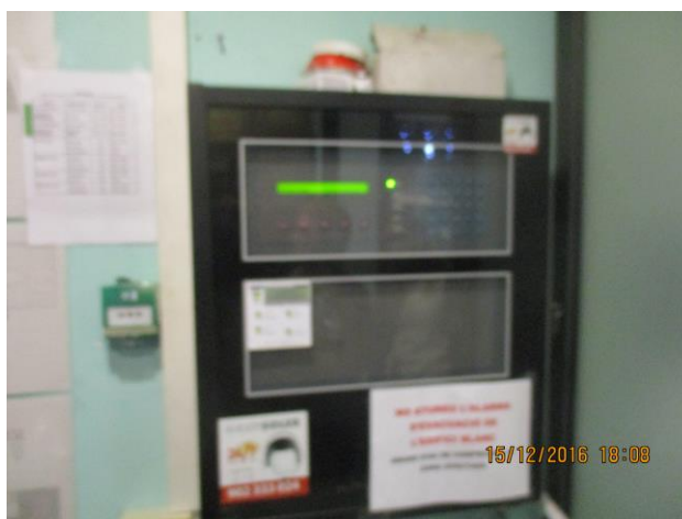
Central d'alarma, polsador d'evacuació a sala de control 24 de Seguretat Vila
